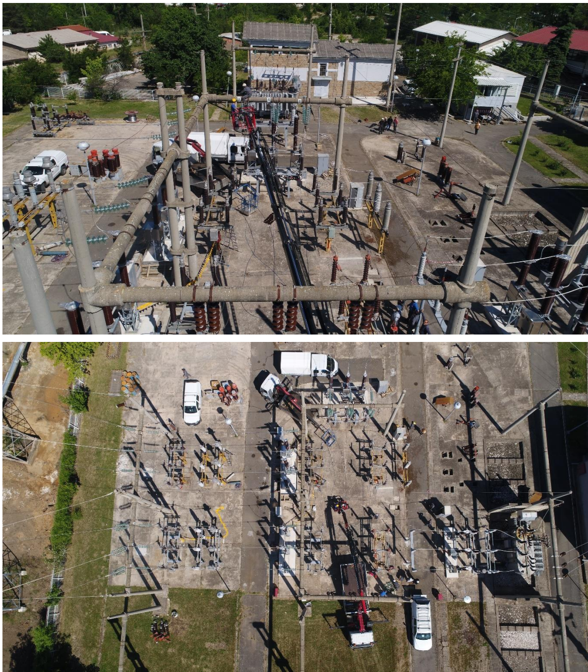
Слика 15. Работа на терен во трансформаторска станица
